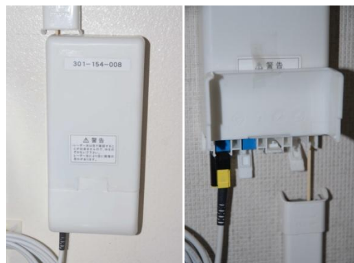
写真1 本学光コンセントの例 (2心のファイバが部屋まで来ている)
